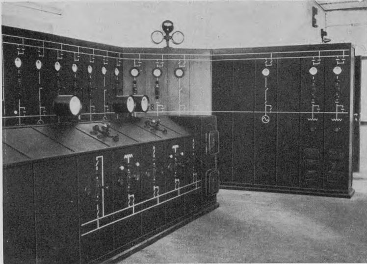
Betjeningspult og Betjeningsstavler for Højspændings-Apparatanlægget paa Finsenværket (Frederiksberg Kommune) 1931
